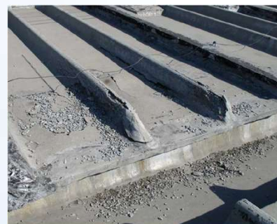
Рис. 3. Разрушение бетона кровельной панели на стыке с водосборным лотком.
