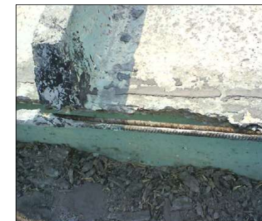
Рис. 4. Разрушение бетона кровельной панели с коррозией арматуры.
